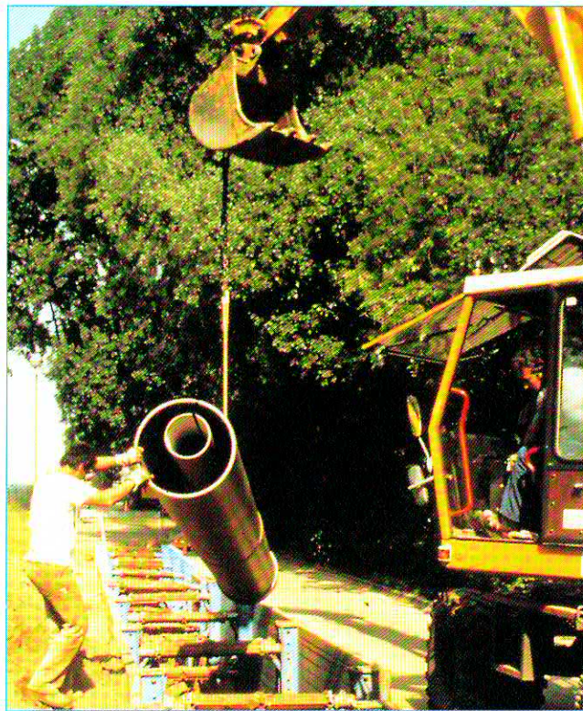
Asymmetrische Doppelrohrleitung DN 400 / DN 800
