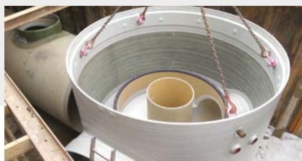
Desbordamiento de emergencia
